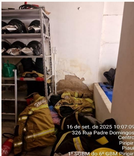
Figura 60 - Almoarifado GBM Piripiri: espaço reduzido para guarda adequada
