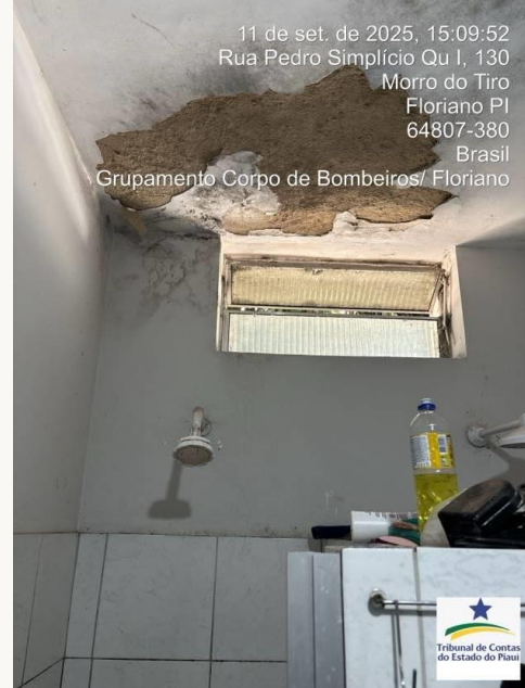
Figura 33 - Banheiro masculino na unidade do GBM de Floriano. Péssimo estado de conservação, necessitando de reparação.
