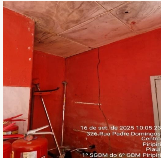
Figura 61 - Almoarifado GBM Piripiri com mofo e infiltração no teto
