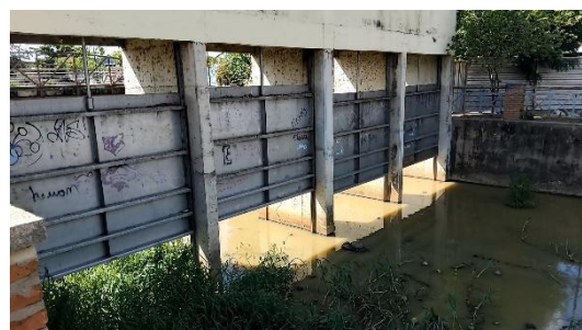
Figura 15 – Sistema de comportas localizado na Rua dos Palmeirais, Mafrense.
