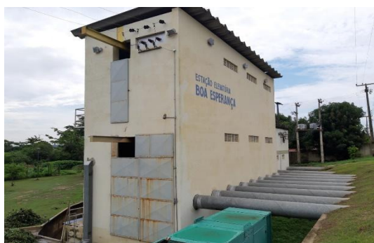
Figura 16 – Sistema de bombeamento das lagoas do norte: Estação Elevatória da Boa Esperança (Fonte: https://pmt.pi.gov.br/tag/bombeamento/ ).
