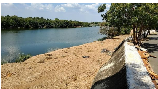
Figura 14 – Dique de concreto nas proximidades do Pesqueirinho.
