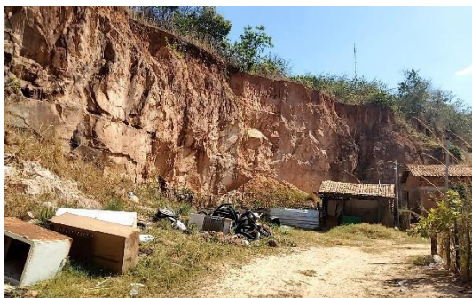
Figura 03 – Vista do chão do talude de corte do bairro Pedro Balzi (setor PI_TERESIN_SR_109_SGB).
