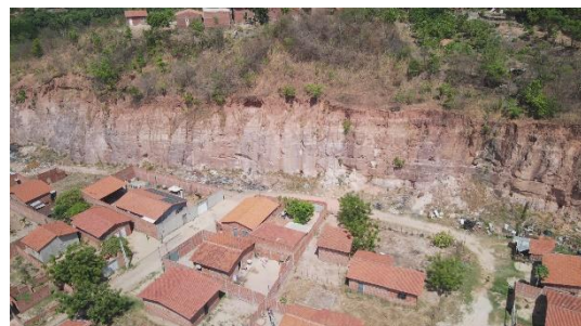
Figura 04 – Vista aérea do bairro Pedro Balzi com destaque para a escavação resultando em um paredão subvertical (setor PI_TERESIN_SR_109_SGB).
